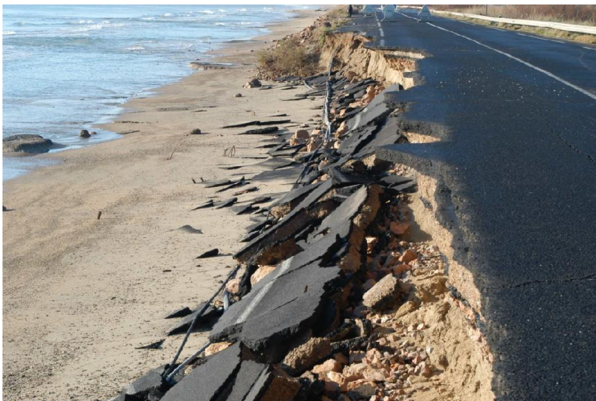
Figure 21 : Erosion de la route du lido de Sète (source : Thau Agglo, 2015)
